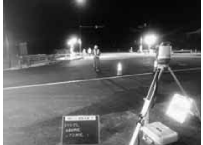
舗装工：出来形管理 切削及びレベルング等の出来形管理をトータルステーション(TS)にて高さ・厚さ管理を行った)
