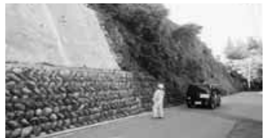
協会員による被災状況確認((一社)金沢建設業協会)
