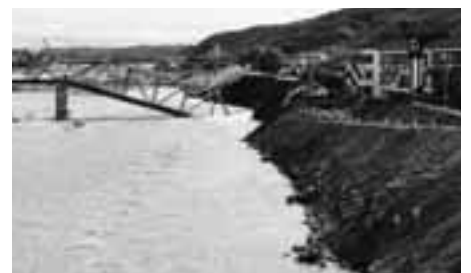
支援要請箇所(長野県上田市)
