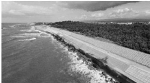
着手前の消波ブロック及び背面構造物損傷状況
