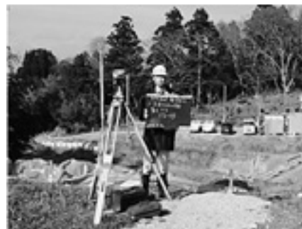
基地局の設置
